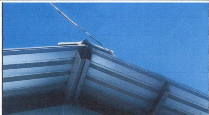
Foto 2: Sustitución de capote, para lámina troquelada aluzinc calibre 26 en módulo de aulas
